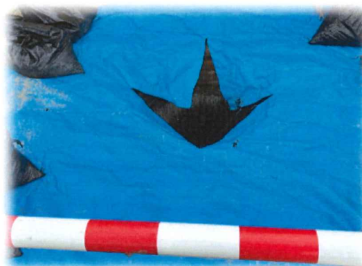
防火水槽マンホール投入口
